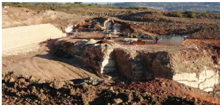
Figura 3 – Vista das transições bruscas entre zonas de aterro e paramentos verticais do maciço calcário, resultantes da exploração anterior do local por pedreiras.
