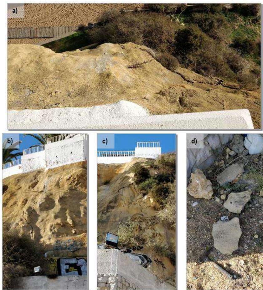
Figura 2 - a) Fissuração de desenvolvimento horizontal e vertical b) betão projetado ao longo da arriba; c) fissuração intensa expondo o maciço natural; d) fragmentos de betão caídos no sopé da arriba
