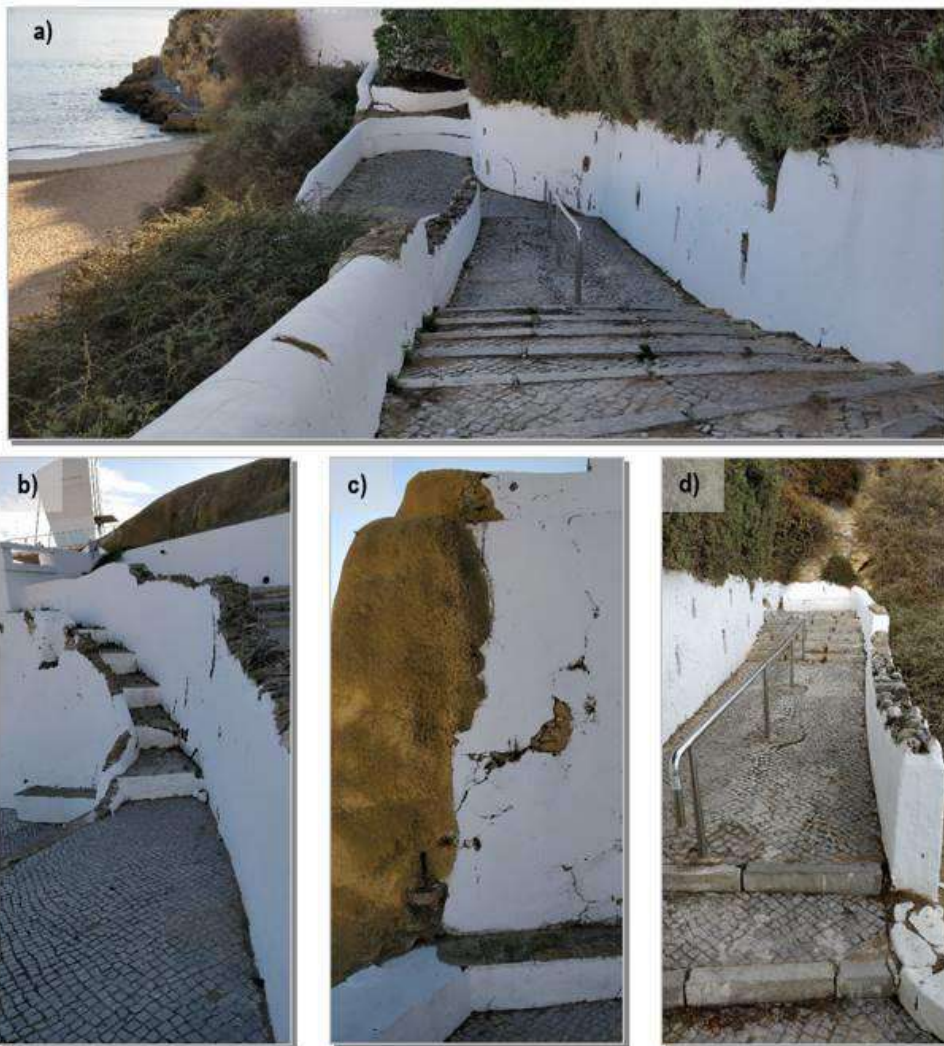
Figura 3 - a) Vista geral das escadas de acesso à praia; b), c), d). Fendas de tração observadas nos pavimentos e muros
