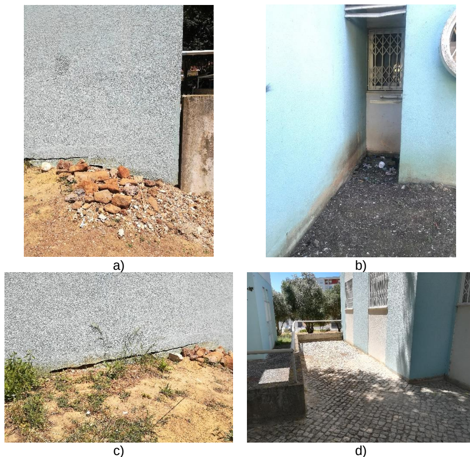
Figura 3 - Patologias/danos exteriores do edifício em estudo: a) destacamento do muro; b) assentamento dos pavimentos; c) fenda horizontal na fachada; d) assentamento dos pavimentos.
